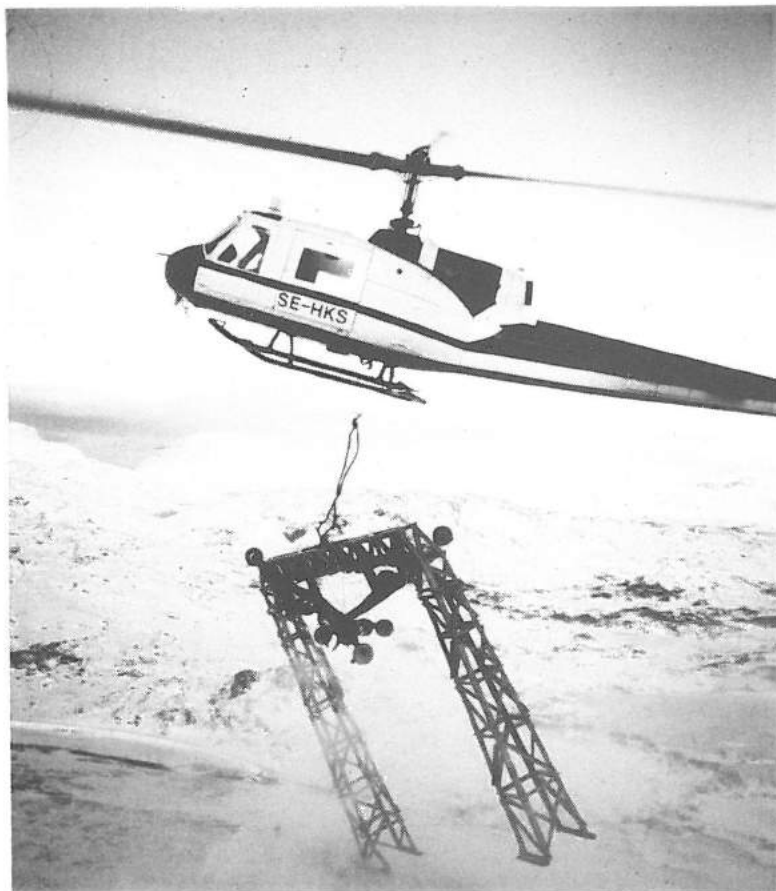
Bild 4. Lasten fälls. Observera att portalens överliggare ännu är oskadad.
