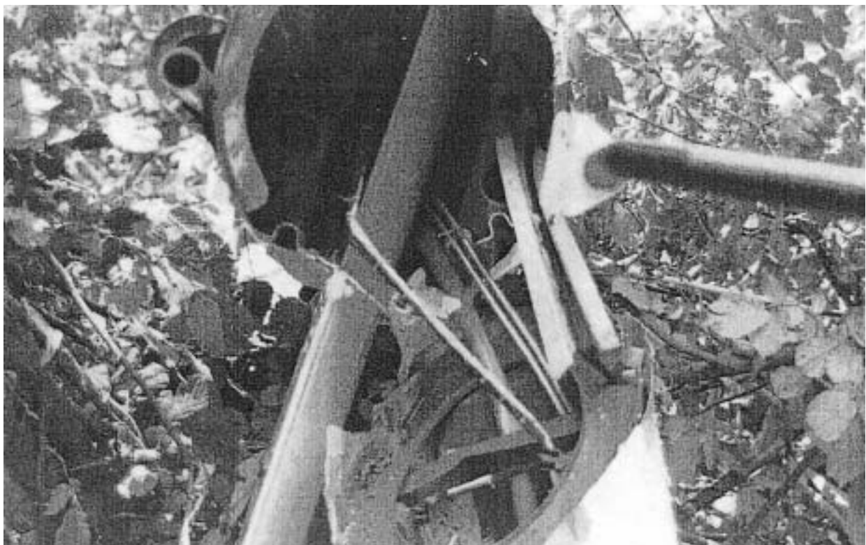
Particolare rottura trave di coda
