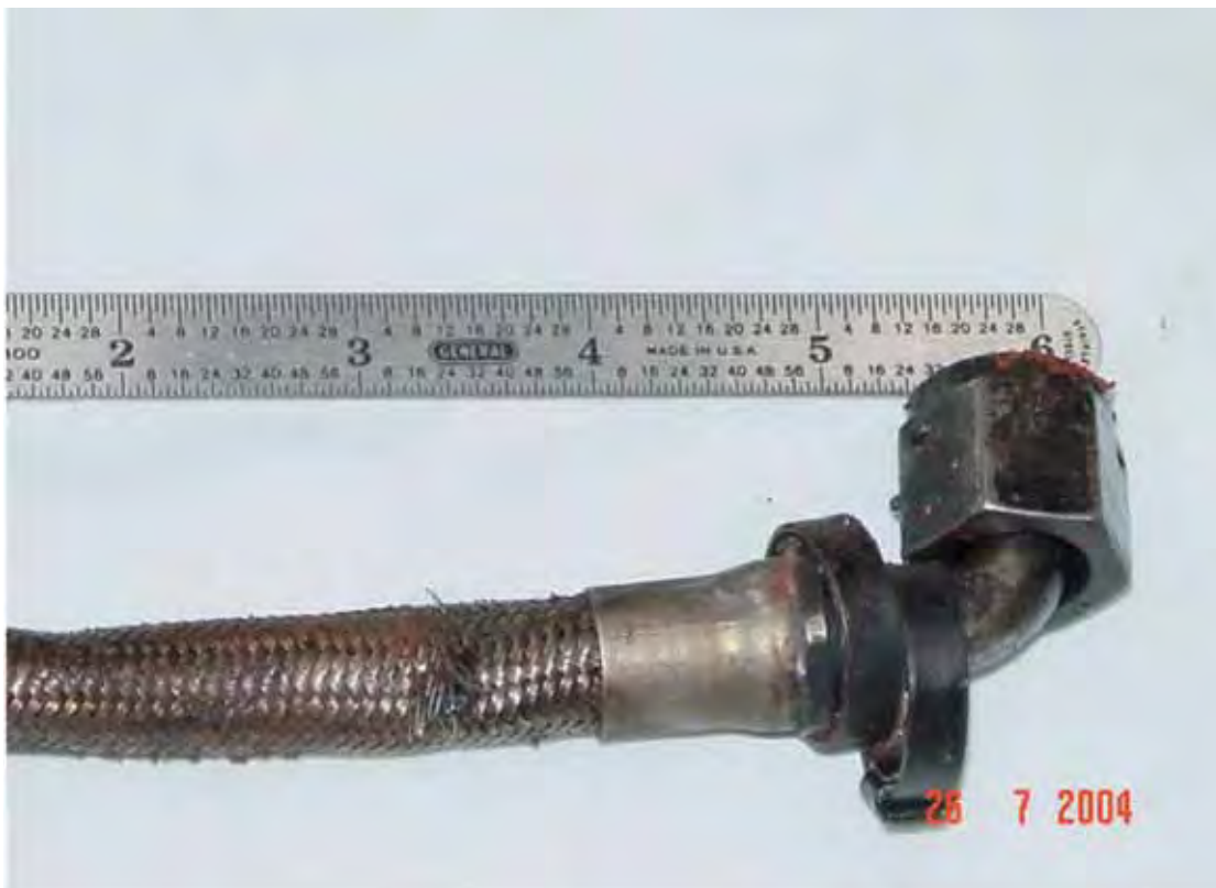
Tubazione flessibile CP11. Particolare della rottura.
