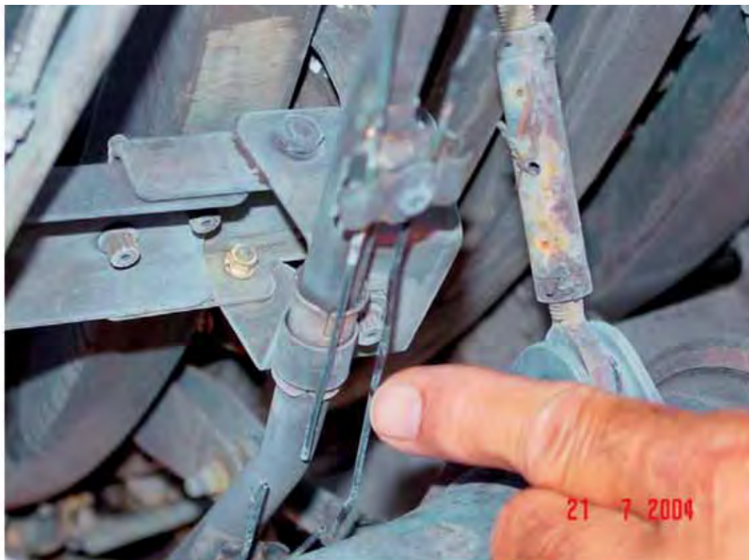
Sistema Fire Detection motore destro, danneggiato a seguito dell'esplosione e del relativo incendio. Particolare fili interrotti.
