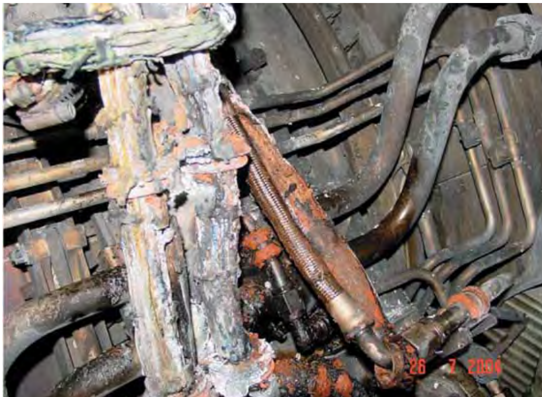
Motore destro. Tubazione flessibile CP11; notare la rottura della maglia metallica a circa 1-1,5 cm dall'estremità inferiore.
