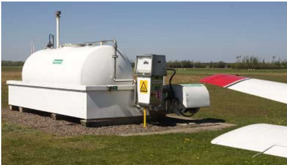
Fig.5. Tankanläggningen på Sjöbo/Sövde flygplats.
