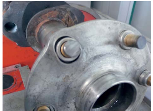
Foto n. 33: dettaglio deformazioni flangia.
