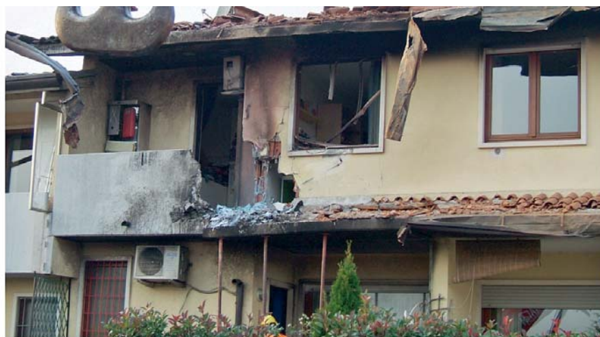
Foto n. 7: danneggiamenti all'abitazione privata.
