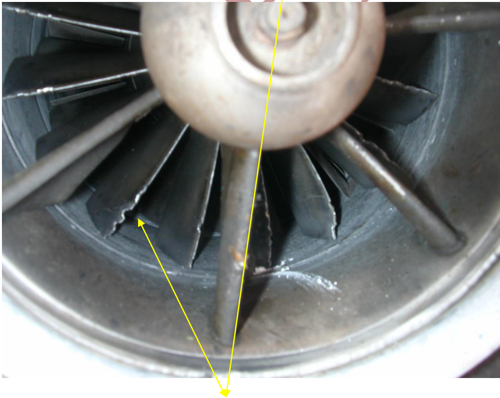
Daños en las primeras etapas del compresor del motor.
