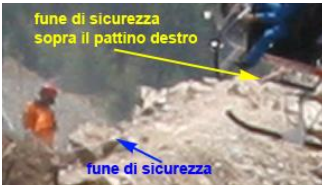
Foto 25: particolare della fune di sicurezza.
