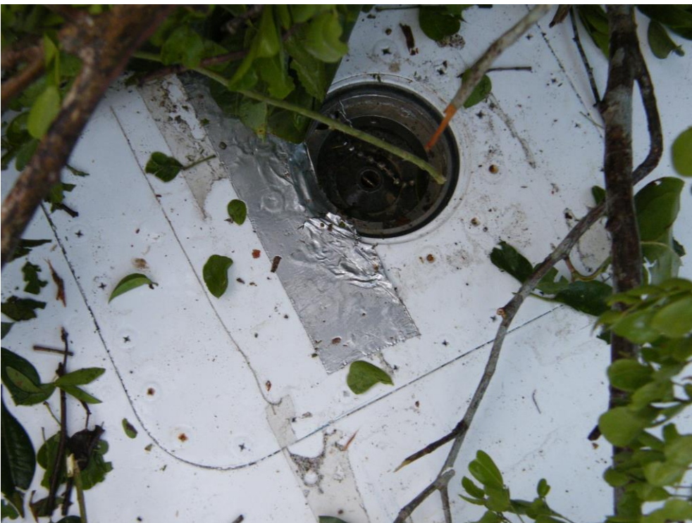
Imagen 05c.- Boca de llenado.
