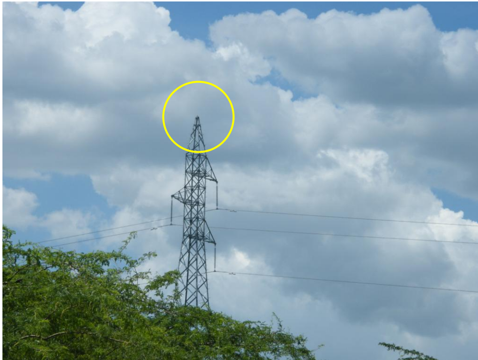
Imagen 01.- Torre de tendido eléctrico de alta tensión. El círculo señala la posición de anclaje del cable de guarda, el cual fue desprendido por el impacto con la aeronave.
