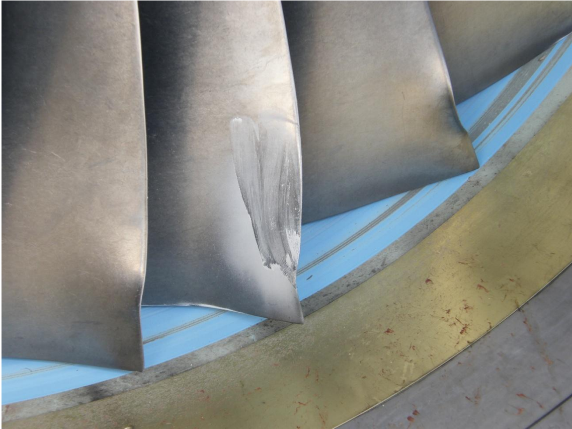
Foto de los daño en los alabes.
