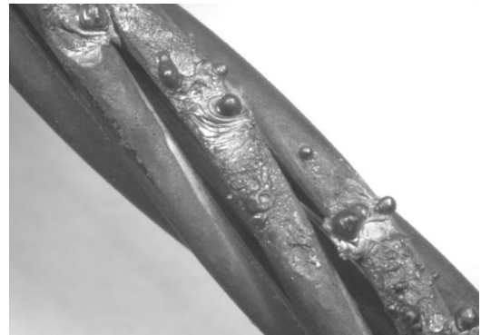
Foto 25: segni fusione su cavo superiore elettrodotto lato Est.
