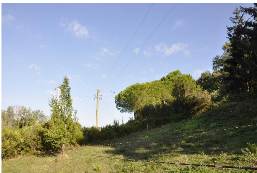
Foto 5: vista elettrodotto in direzione Ovest-Nord Ovest con assenza cavo superiore.
