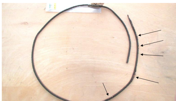
Foto 19: tratto cavo elettrodotta lato Ovest con con segni fusione prossimi al punto di rottura.
