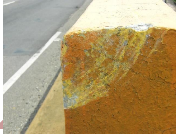
Marca de impacto dejada por el ala derecha en la baranda de seguridad del puente.
