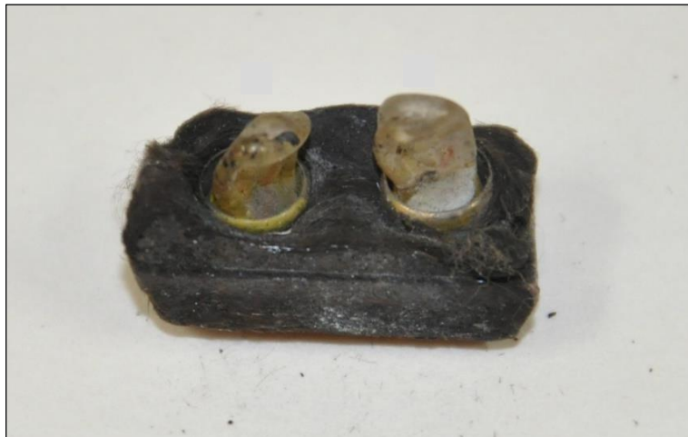
圖 1.16-16 警示燈燈座及燈泡受損情形
