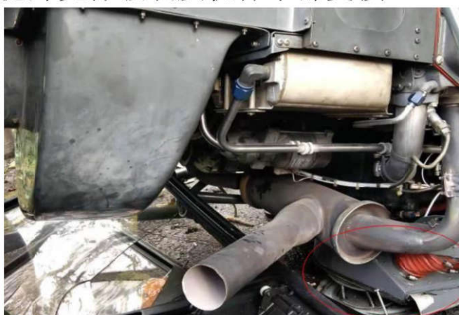
图 8：空气滤外壳体破裂及机体下部受损
