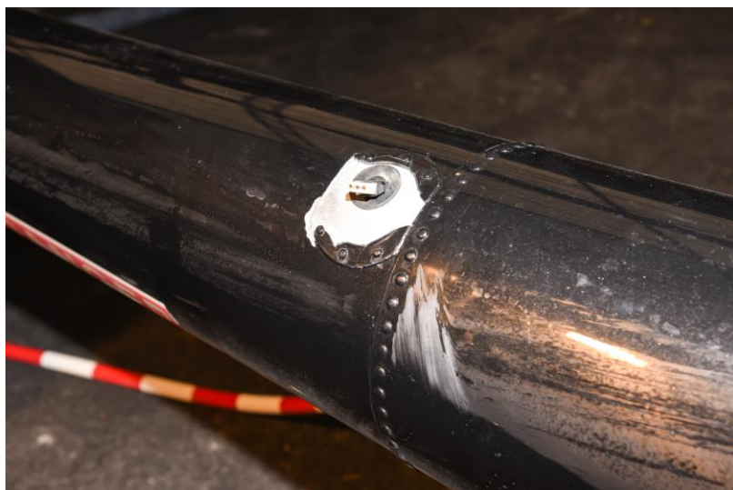
Figur 7. Skador längs sidan av bommen.
