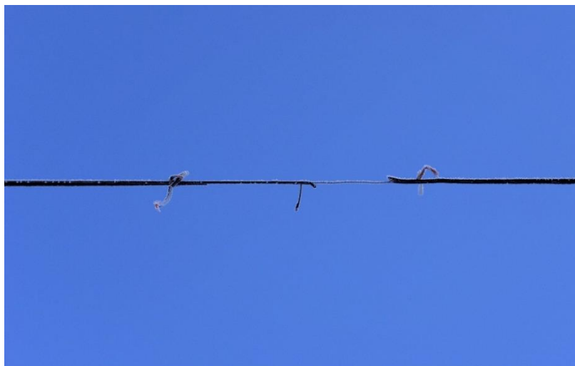
Figur 6. Skador på telefonledning.
