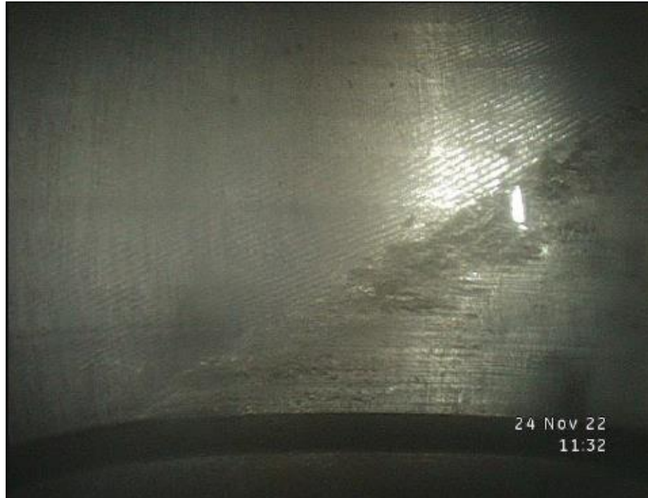
Figur 32. Bild på ytdefekten i höjd med den skadade tätningen. Foto: Element Materials Technology AB.
